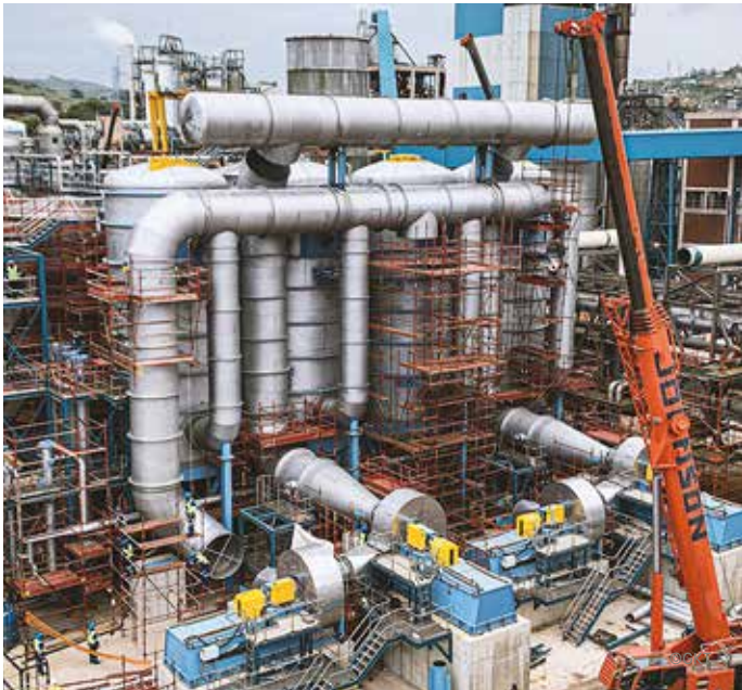
Mechanische Brüdenverdichtung (MBV)
