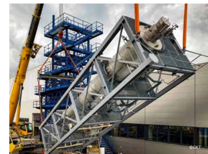
Dünnschichtverdampfer - Skid Unit
