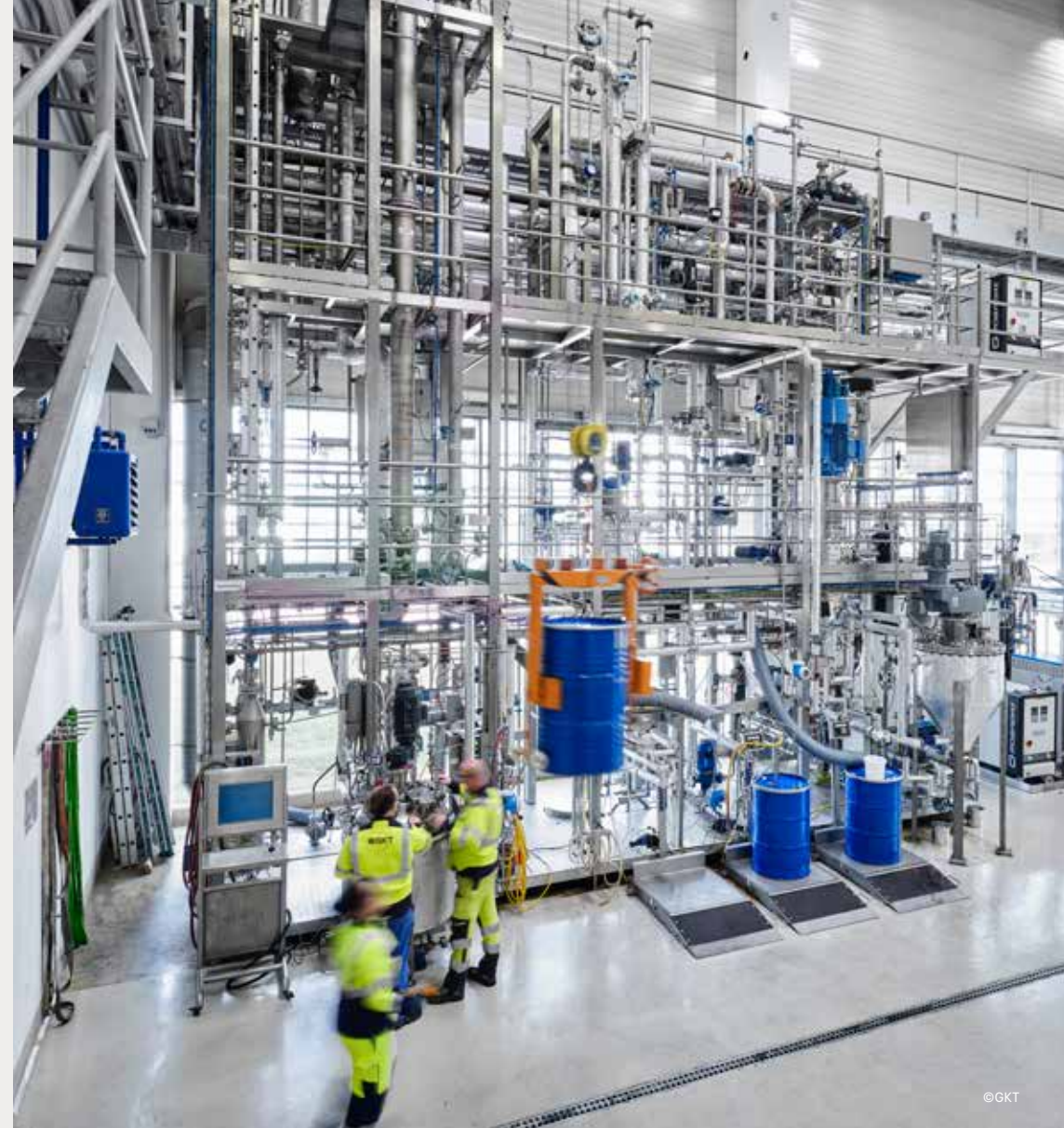
← Technikum für Labor- und Pilotversuche in Gloggnitz, Österreich
